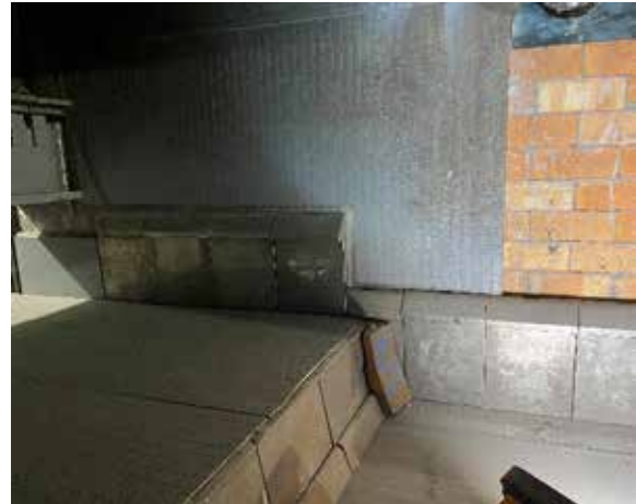
Zuteiler nach Erneuerung
